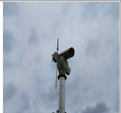
부품 단종 CCTV
